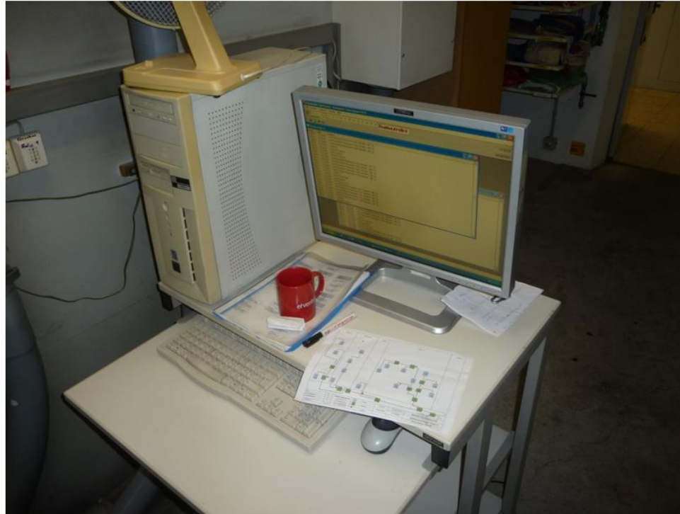
Abb. 2: PC zur Überwachung der Anlage
