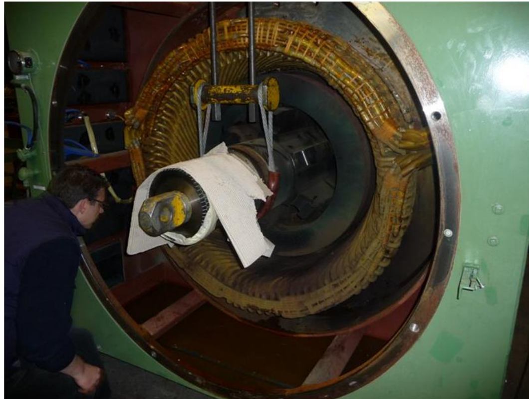
Abb. 34: Freiliegende Wicklungen des Stators
