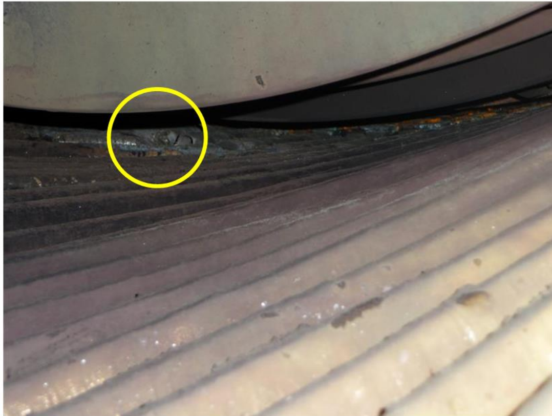
Abb. 35: Erkennbare Schäden durch Lichtbögen (Kreis)
