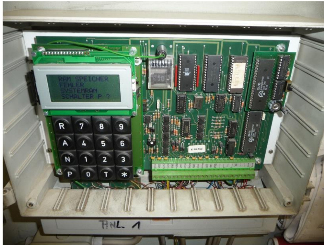
Abb. 5: Zentrale für Linie 1, Display mit Fehleranzeige
